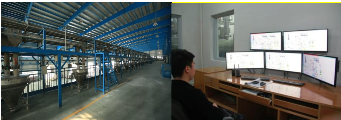
图 15 公司智能全封闭式粉料集中输配系统
